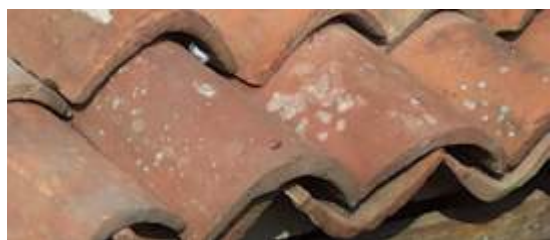
Fig.55: coppi senza grondaia
