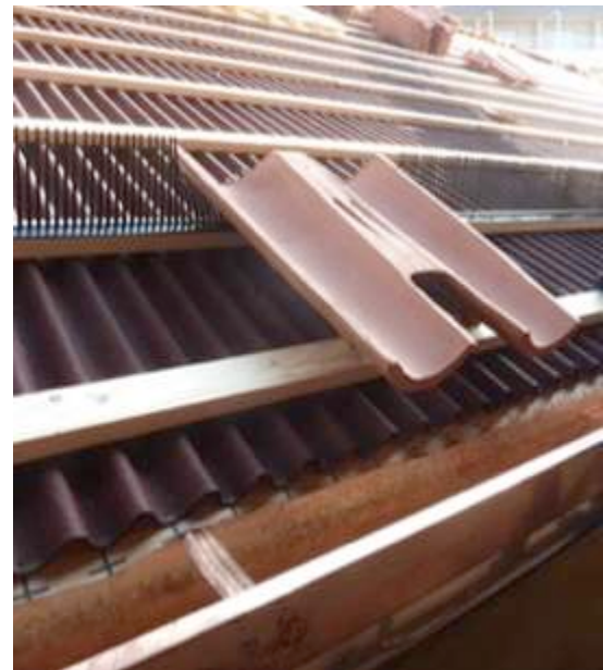
Fig.101: procedura per la posa di una copertura a coppi con arretramento pettini para passero
