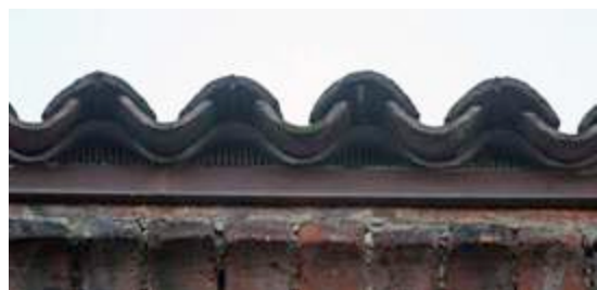
Fig.65: Università Statale Festa del Perdono - MI. Coppi chiusi da rete para passeri
