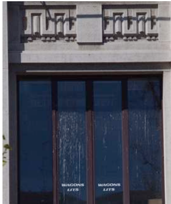
Fig.70: Stazione Centrale – MI, deiezioni sui vetri
